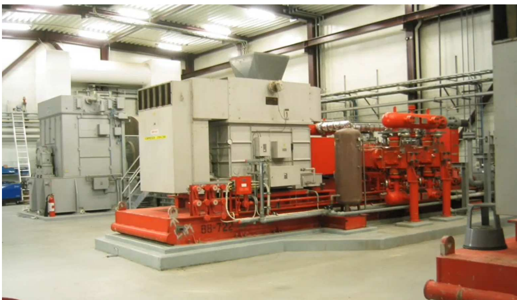
Abbildung 4-4 – Gebäude mit Kompressoren in Stenlille. 9
