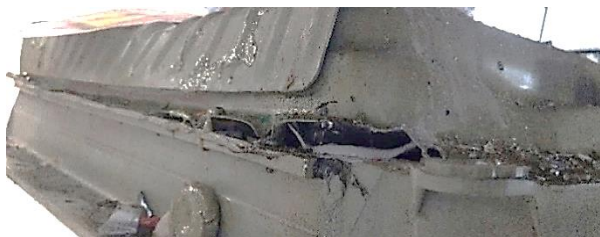
Her ses en batterikasse med tydelige skader.
