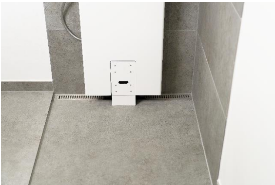
Billede 3: Indsugning ved gulv (linjeafløb)
