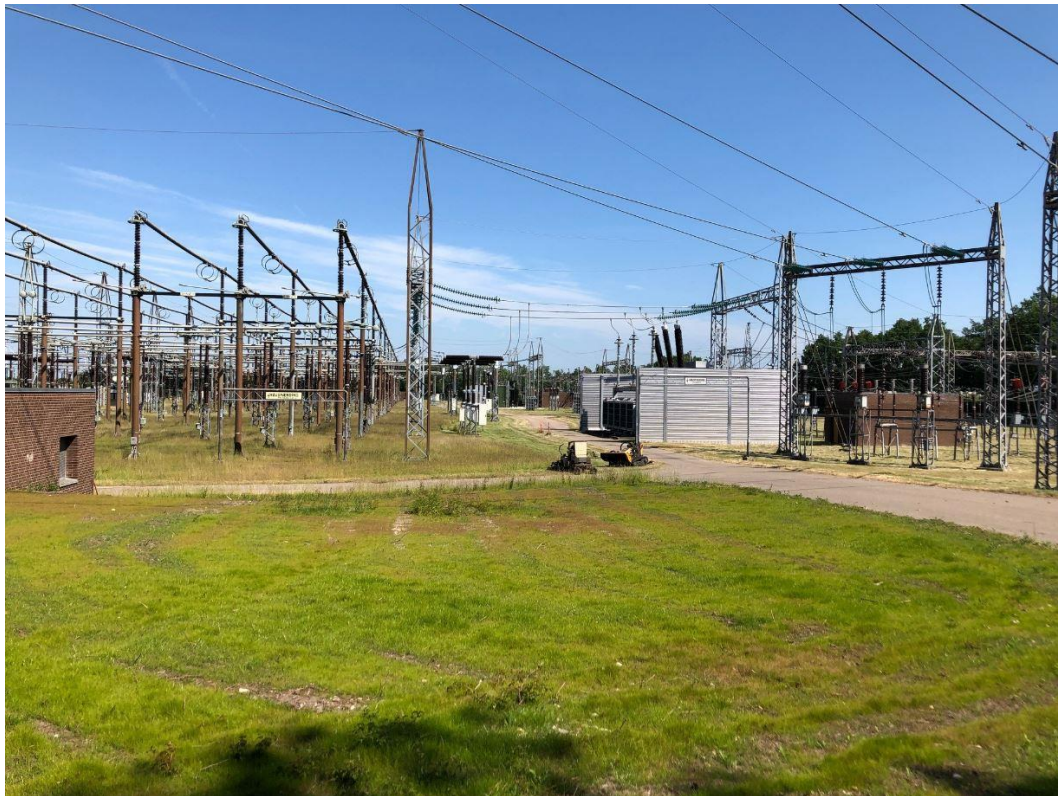
Figur 1-6: Støjafskærmning (i form af støjvægge) på den eksisterende Hovegård Højspændingsstation.
