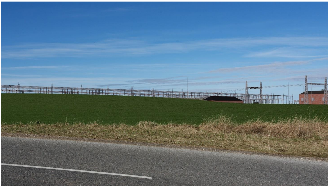
Figur 7.21 Et eksempel på, hvor synligt udvidelsen af Hovegård Højspændingsstation mod øst kan blive set fra sydøst. I eksemplet er et åbent anlæg placeret med stor afstand til planområdets østlige grænse, hvorved terrænet kan have en delvist afskærmende effekt (Illustration: NIRAS A/S).
