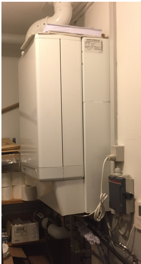
Figur 7 Daikin gashybridvarmepumpe placeret i en af skolens pavilloner med gasfyr og varmepumpens indedel bygget sammen i én unit.
