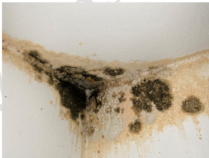
Figur 1: Omfattende fugtskade og skimmelsvampevækst.
