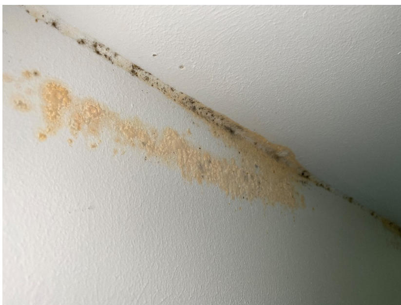
Figur 3: Kuldebro med fugt og skimmelvækst
