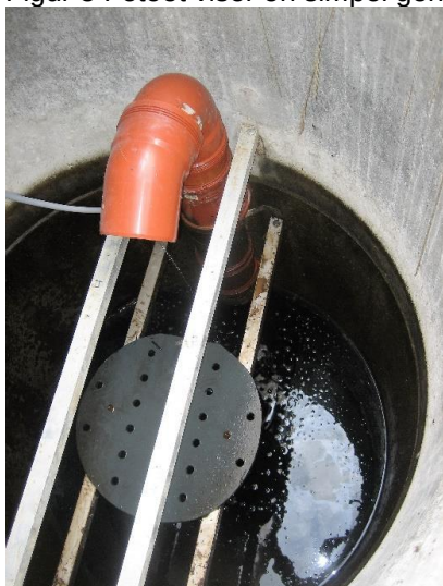
Figur 8 Fotoet viser en simpel geniltningsbrønd med en hullet plade, der medvirker ved geniltning.
