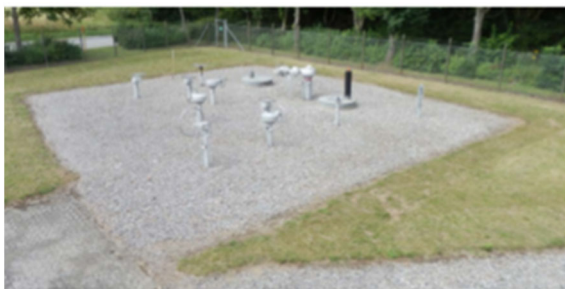
Figur 9 Eksempler på en linjeventilstation. Som udgangspunkt er kun dæksler og rør synlige over terræn. Hvis der skal være en katodisk beskyttelsesstation på en LV-station vil den være synlig.
